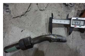
図 26 破断後のアンカーボルト
