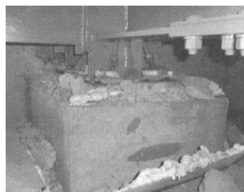
図 2 支承部の被害例
