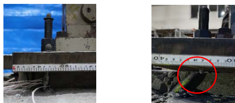
(f) アンカーボルトの傾き (g) アンカーボルト破断
