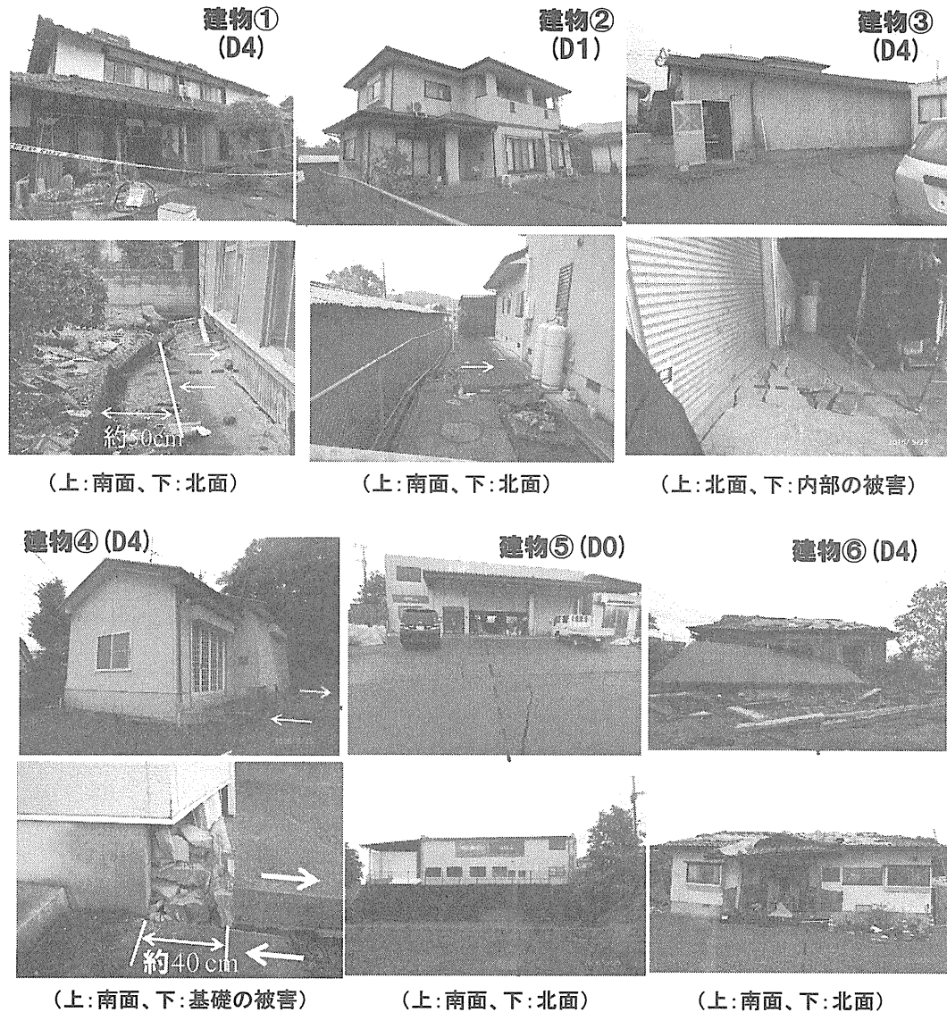
図 11 高木（南部）の地表地震断層直上の建物被害例（建物の位置は図 10 を参照）
