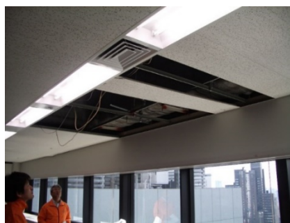
写真 1 天井板の落下被害 28 階会議室
