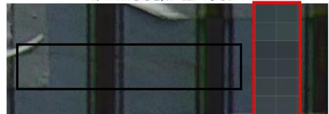
b) 0.1mm ひび割れ (加工有り-中間色域の黒色の強調)
