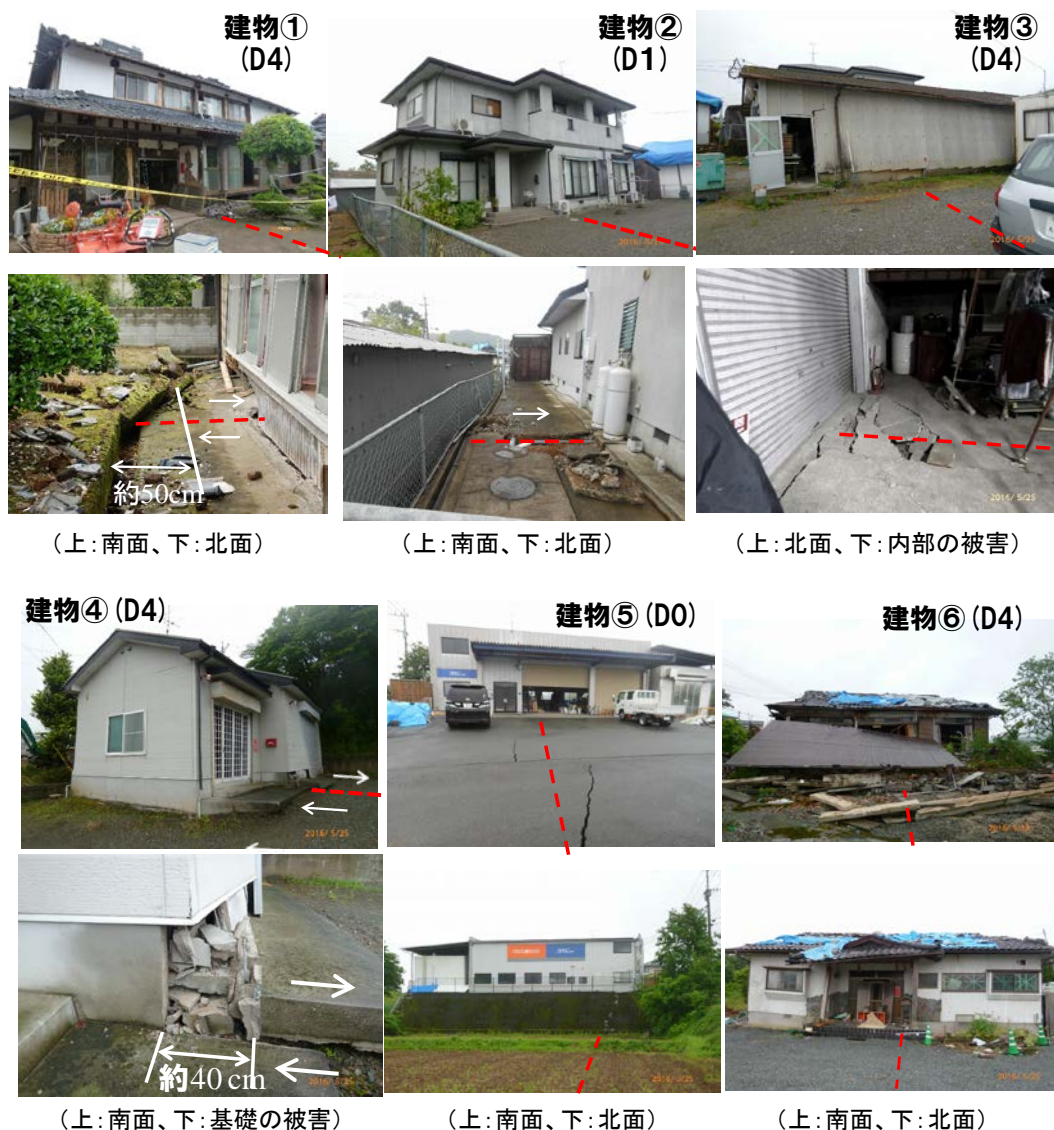
図 11 高木（南部）の地表地震断層直上の建物被害例（建物の位置は図 10 を参照）
