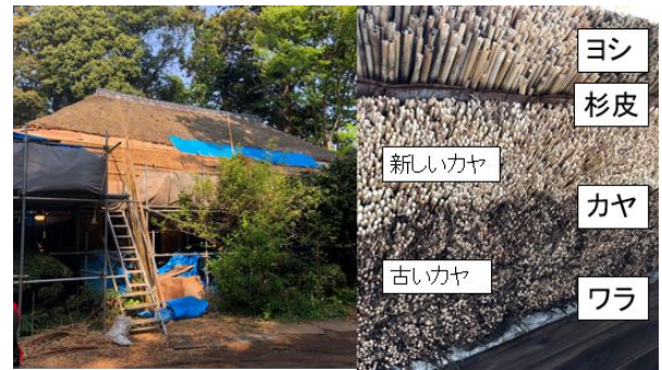
a) 現場画像 b) 軒先断面画像
