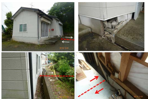
図 19 図 18 の北に位置する断層変位と、その直上の古い木造建物の被害の様子
