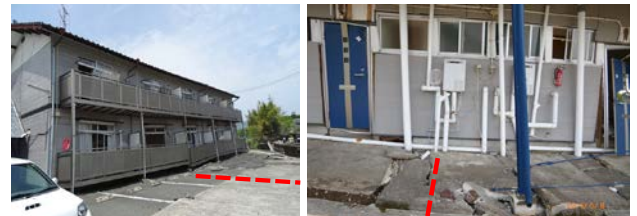
図 26 断層直上の古い木造建物の被害。無筋のコンクリート基礎が破壊され、上部構造も変形した（久田ほか、2019）
