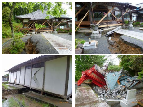
図 12 いわき市・建徳寺における断層直上の非常に古い伝統木造の本堂と山門の被害の様子（撮影：久田）
