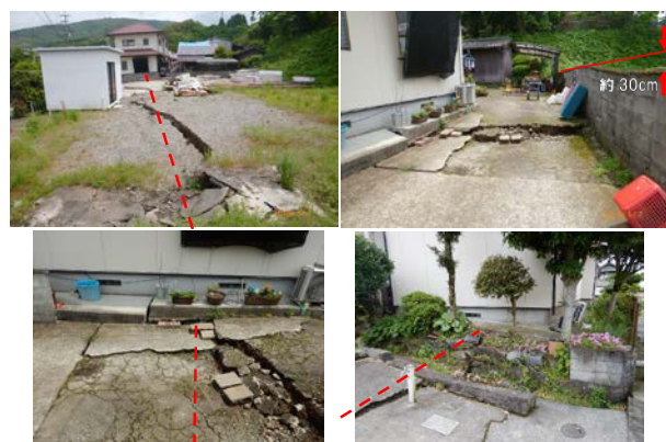
図 21 約 30cm の縦ずれ断層変位と、その直上の新しい木造建物の被害の様子
