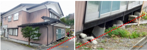
図 15 図 14 に南面する古い在来木造住宅（撮影：松澤氏）。基礎は無筋の布基礎と束基礎であり、断層変位で基礎が破壊され、柱も移動していた（1年後には取壊し確認）
