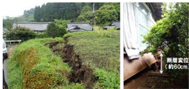
図 25 約 60 cm の縦ずれ断層変位と、直上の築約 80 年の木造建物の被害の様子。縦ずれ変位に建物が追随し、遠目からも屋根の変形が確認できる
