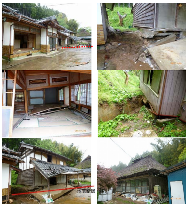
図 11 宇塩ノ平における断層直上の古い木造家屋と納屋の被害の様子（撮影：久田）
