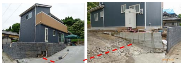
図 22 約 30cm の横ずれ断層変位と、その直上の新しい木造建物の様子（久田ほか、2019）
