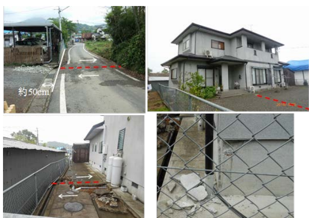
図 18 図 17 の北隣の横ずれ断層変位と、その直上の新しい木造住宅の被害の様子
