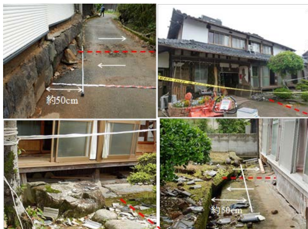
図 17 2016 年熊本地震における横ずれ断層変位と、その直上の非常に古い伝統木造住宅の被害の様子
