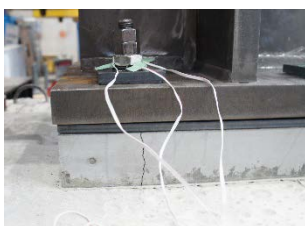
(a) モルタルひび割れ
