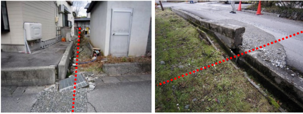
図 14 白馬村大出における断層変位（左：建物を避けて敷地境界に現れている、右：南に隣接する図 25 の建物の前面道路の側溝の上下変位：撮影：久田・石川）
