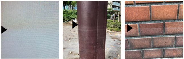
写真2 水害発生浸水高跡
