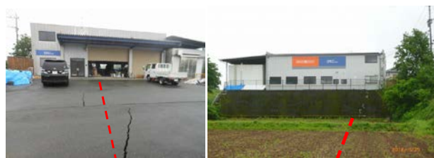
図 20 断層変位によると擁壁の亀裂と、直上の新しい S 造工場の様子
