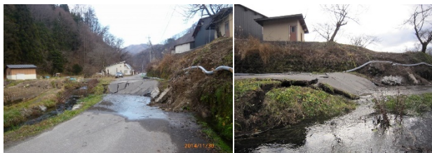
図 13 白馬村森上における断層変位（上下に約 80 cm）と上盤側の建物の様子（撮影：久田・石川）
