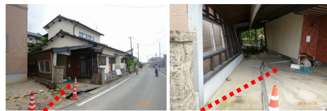
図 24 断層変位と直上の古い木造建物の被害。無筋のコンクリート基礎が破壊され、上部構造も変形した
