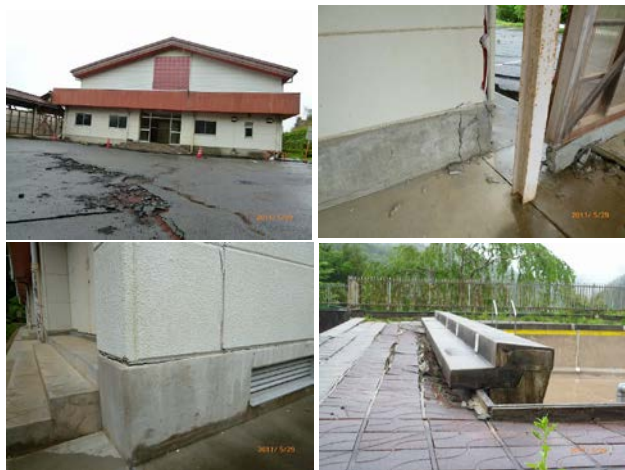
図 10 2011 年福島県浜通り地震による田人中学校の S 造体育館（西向きに 2-3 度傾斜）と裏の水泳場における断層変位による被害の様子（撮影：久田）
