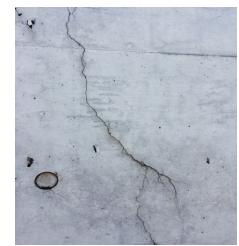
b) 劣化箇所写真
