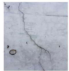
b) 劣化箇所写真
