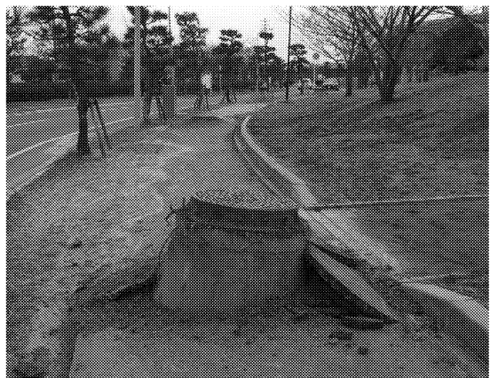
写真1 千葉県液状化被害
