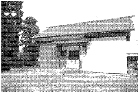
東日本大震災で被害が発生した土蔵
