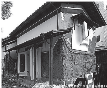
地震による土蔵壁の崩落
