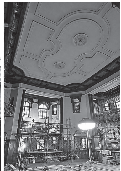
剥落の懸念がある左官天井(高さ9m)
