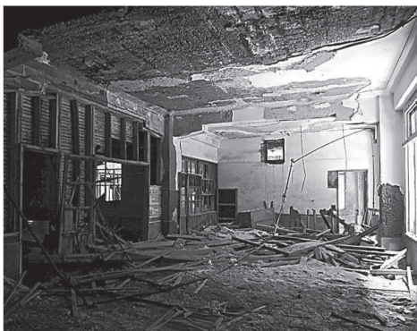
経年劣化による左官材の剥落
