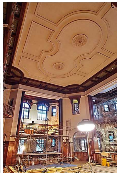
剥落の懸念がある左官天井(高さ9m)
