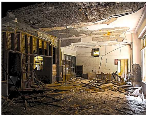
経年劣化による左官材の剥落
