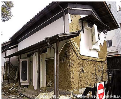
地震による土蔵壁の崩落
